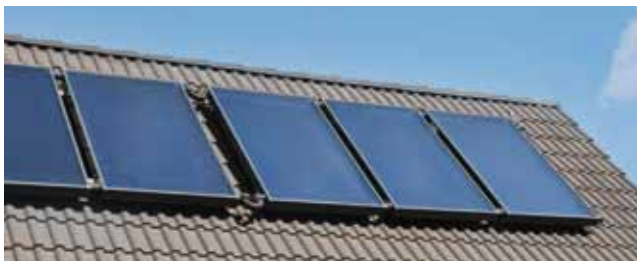
Optimale Ergänzung: die Solaranlage
