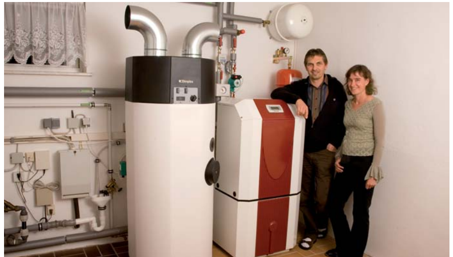
Die Sole/Wasser Wärmepumpe wurde im Heizungskeller anstelle des alten Ölbrenners installiert. Über Erdsonden bezieht sie die Wärmeenergie aus dem Erdreich und führt diese als Heizwärme dem Heizkreislauf zu
