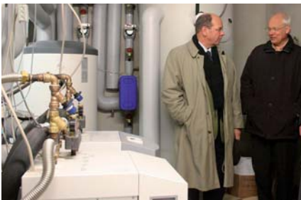
Bauherr Dr. Ulrich Stiebel mit Haustechnik-Experte Dr. Wolfgang von Werder (rechts) im Technikraum
