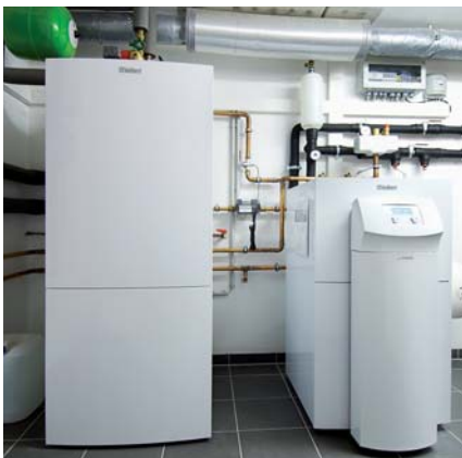
Die Wärmepumpe deckt rund 75 Prozent des Wärmebedarfs der Familie mit kostenloser Erdwärme ab
